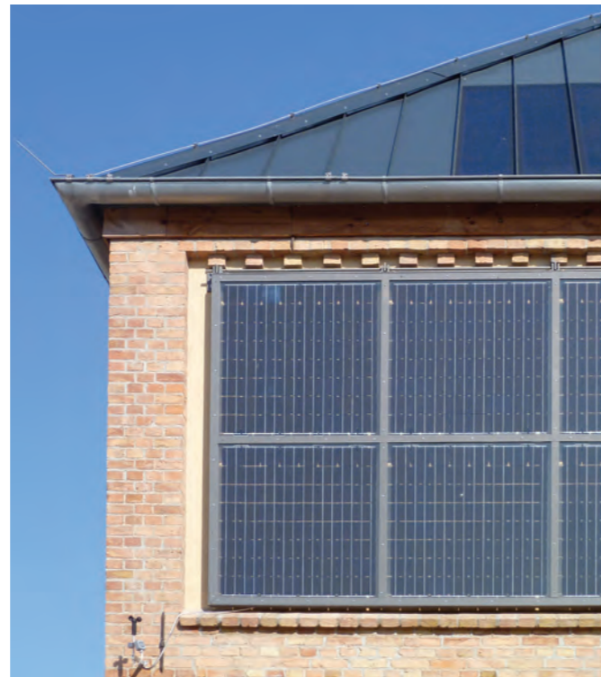
Solarstromgewinnung auf dem Dach und an der Fassade – auch beim Altbau attraktiv
